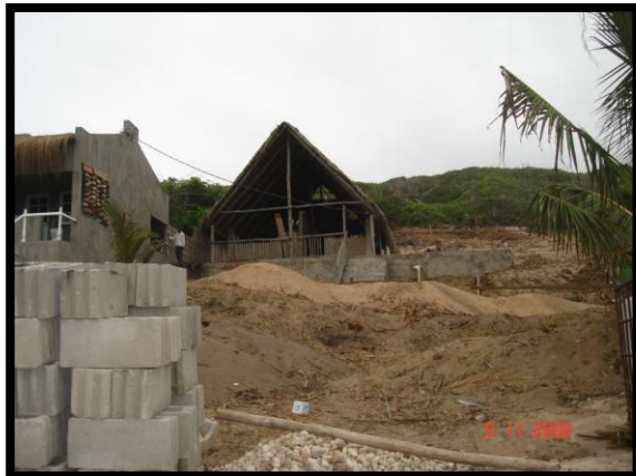
Figura 5: Destruição do habitat dunar
